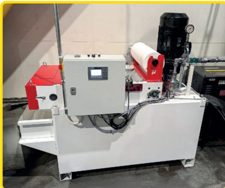
Korkeapaineyksikkö asiakkaalle asennettuna ja käyttövalmiina
